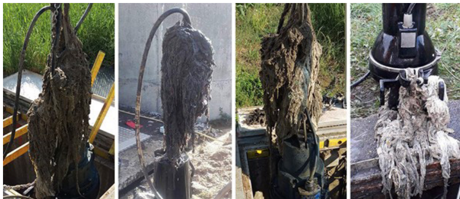
Exemples d'accumulation de lingettes autour des pompes
